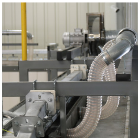
Campanas de extracción a lo largo de toda la longitud del carril
