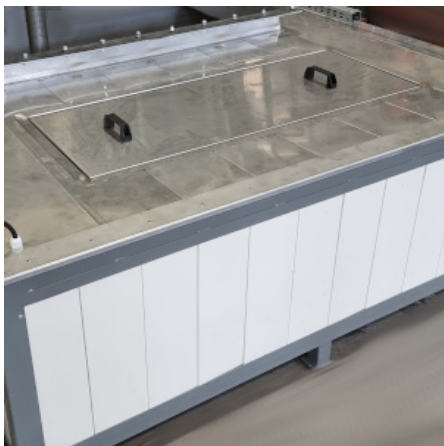
Facile accesso ai serbatoi dall'esterno dell'autolavaggio
